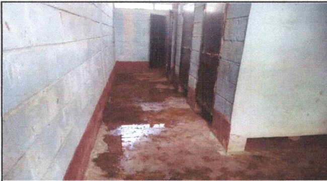
Foto 3: SE OBSERVA EL MODULO DE LOS BAÑOS HUMEDAD EN EL PISO
