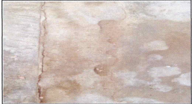
Foto 2: SE OBSERVA EL DETERIORO DEL PISO DEL MODULO 2
